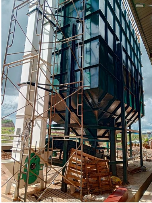
ပုံ(5) ထုတ်ကုန်များကို လေလုံကန်(Silo)များဖြင့် သိုလှောင်ထားမည့်နေရာ
