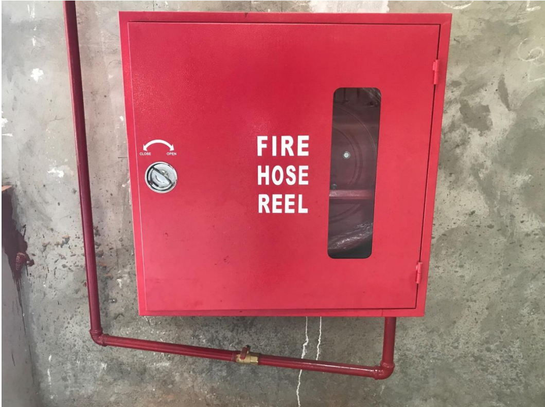
မီးသတ်စနစ်များ ဆောင်ရွက်ထားရှိခြင်း
