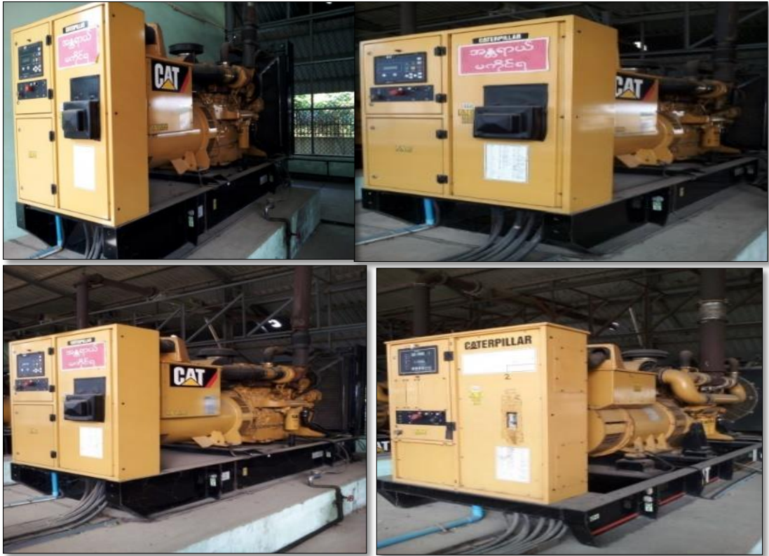
ပုံ(၄-၄၄) Generator များ
