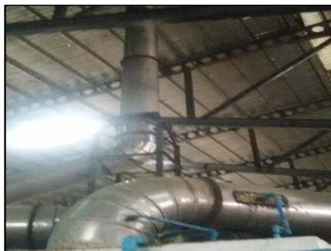
ပုံ(၆-၈) Air Scrubber မှ အထွက် အရိုးအငွေ့ များစုယူသောအရိုးပိုက်
