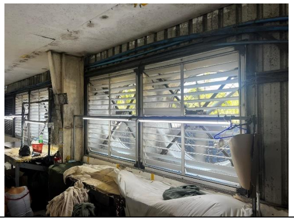
လေဝင်လေထွက် ကောင်းမွန်စေရန် ပန်ကာများဆောင်ရွက်ထားမှု
