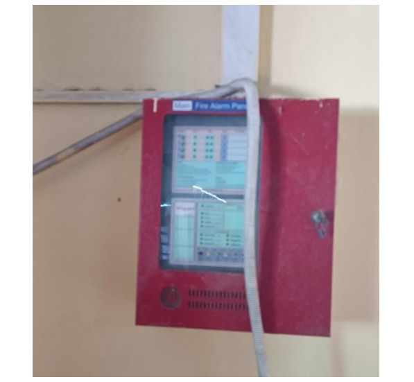
မီးသတိပေးစနစ်ဆောင်ရွက်ထားမှု
