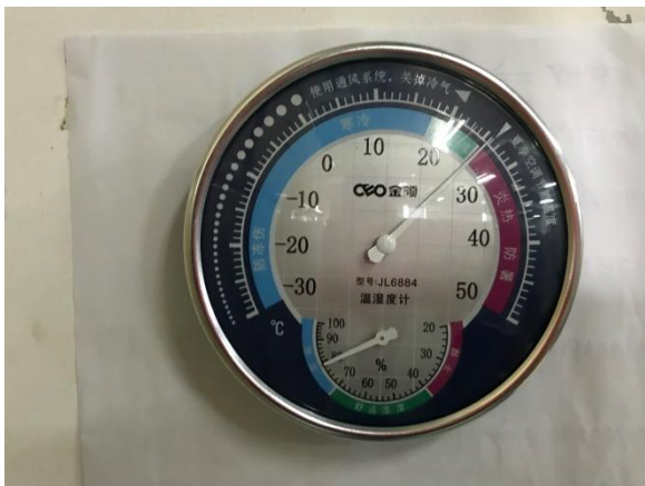
Humidity Meter တပ်ဆင်ထားပုံ
