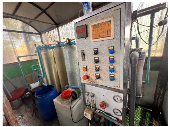
ရေသန့်စက် ဆောင်ရွက်ထားရှိမှု
