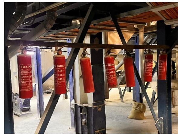
မီးသတ်စနစ်ဆောင်ရွက်ထားရှိမှု
