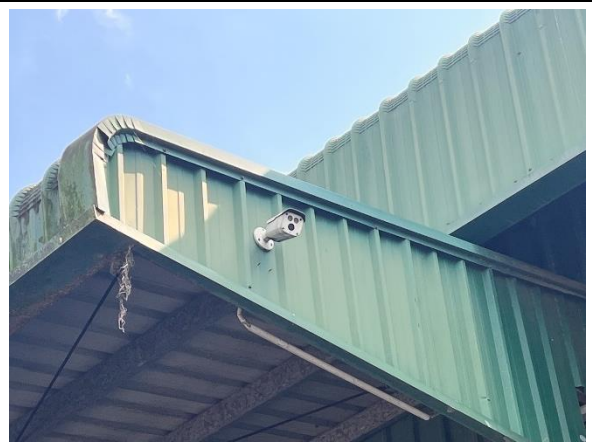
လုံခြုံရေးအတွက် CCTV ကင်မရာ တင်ဆင်ထားရှိမှု
